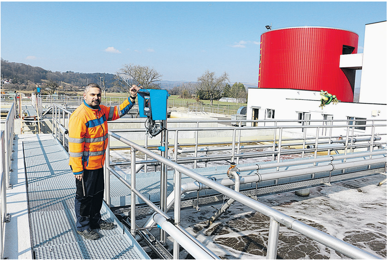
Betriebsleiter Andreas Lehr auf der neuen Anlage.
