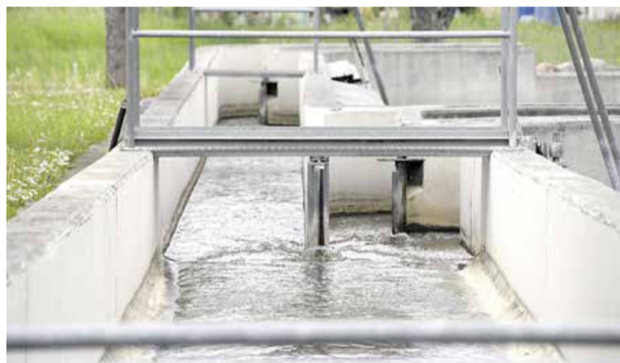
Blick in die Zulauftrassen, über die das Abwasser in die Vorklärbecken geführt wird.
