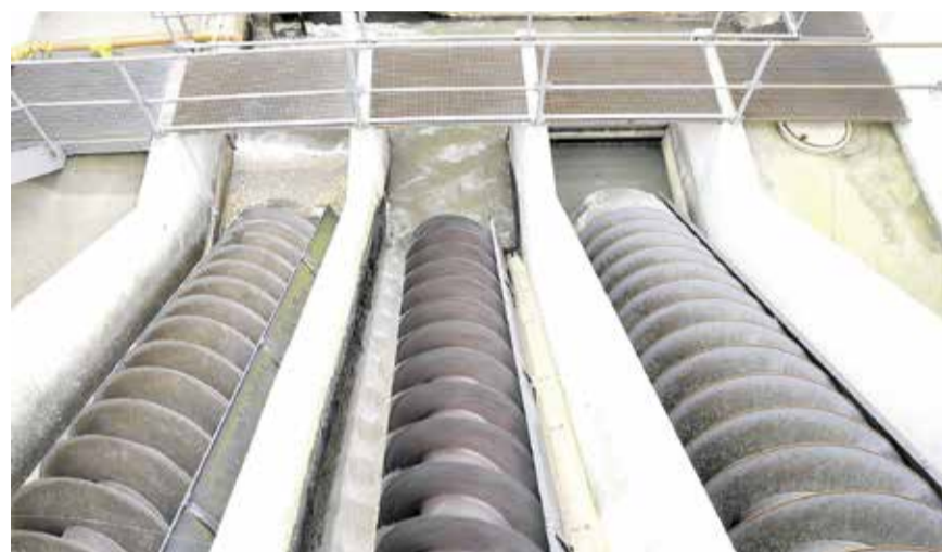
Mit Förderschnecken wird das Abwasser zum höchsten Punkt der Anlage befördert.
