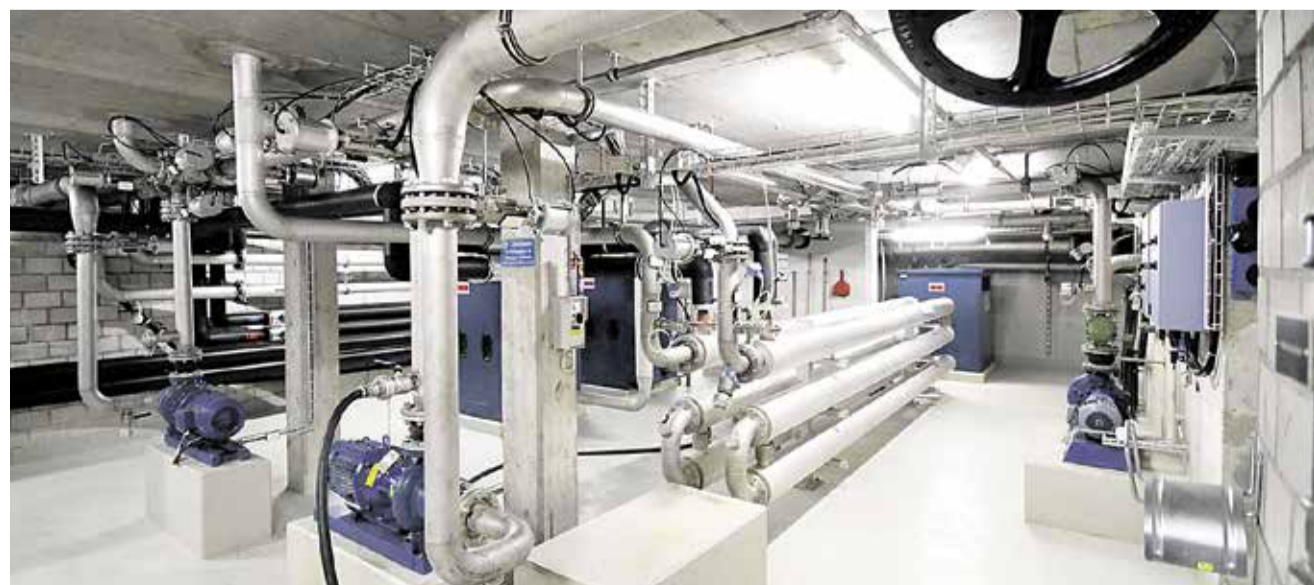
In der ARA wird nicht nur Abwasser gereinigt, es wird auch Energie produziert. Um beides zu ermöglichen, ist im Untergrund der ARA sehr viel Technik notwendig. Blick in den Raum mit Wärmetauscher und Belüftern.
