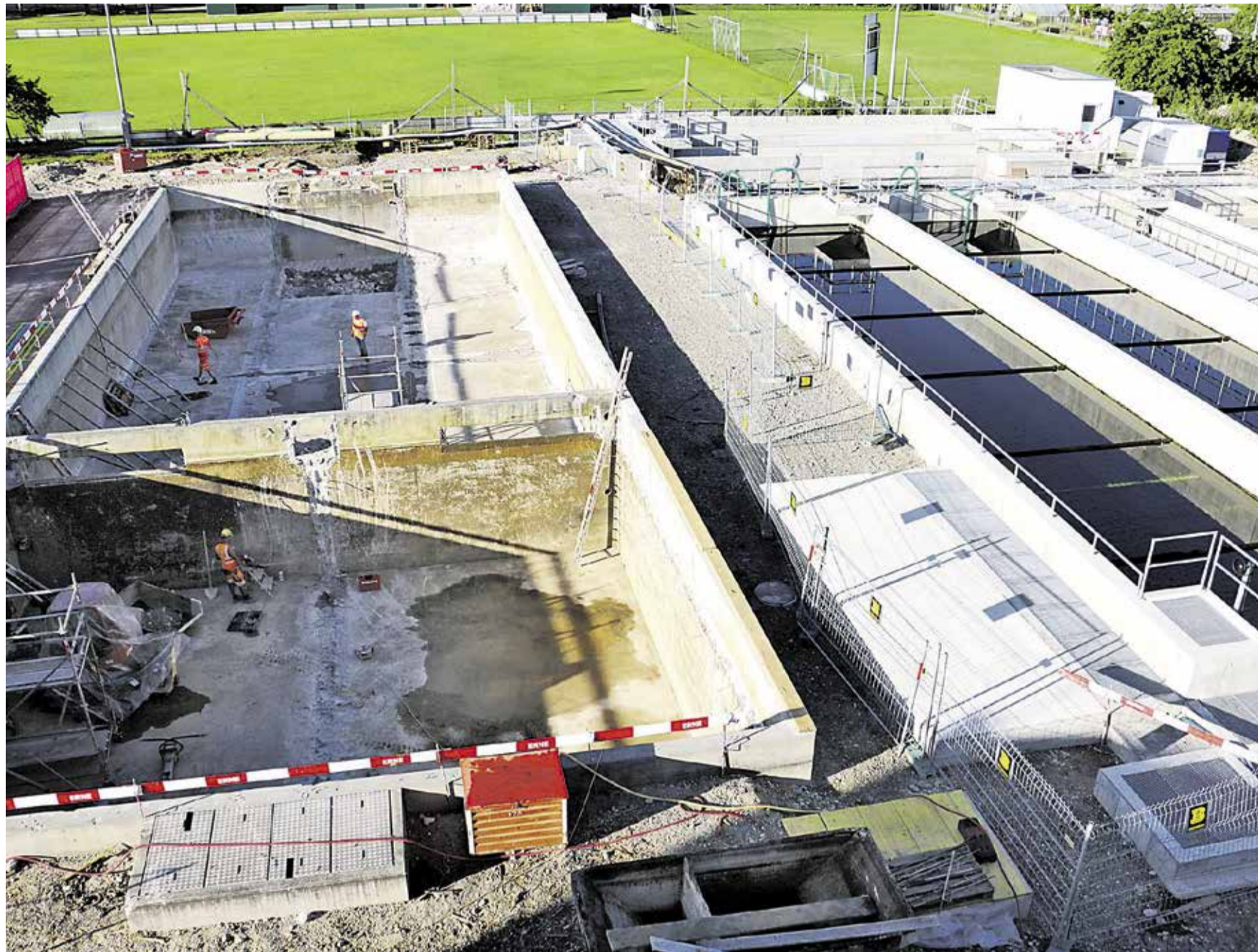
Zwei neue Becken rechts sind schon in Betrieb, während der Altbau links saniert wird.
